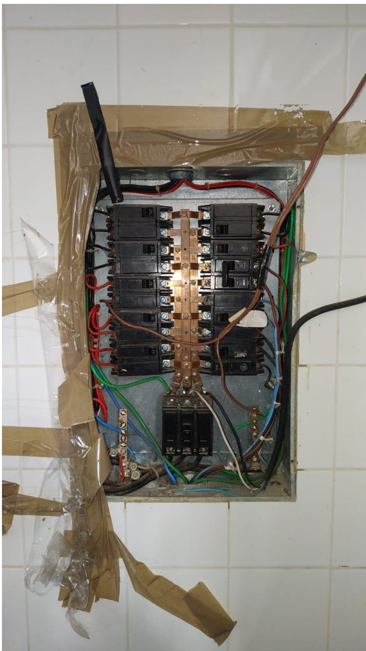
Estado do quadro de disjuntores que está previsto para ser substituído
