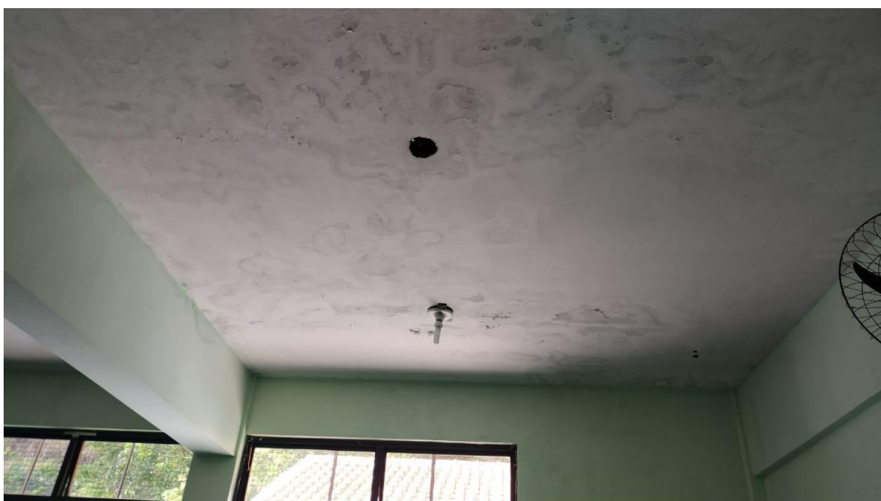
3.3. Danos nas lajes das salas de aulas causados pelas infiltrações pelo telhado atual
