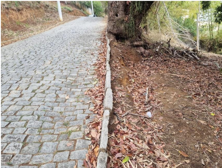
Desnível do trecho, com tombamento do meio fio.
