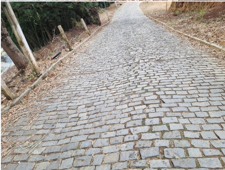
Vista geral do desnível do trecho.
