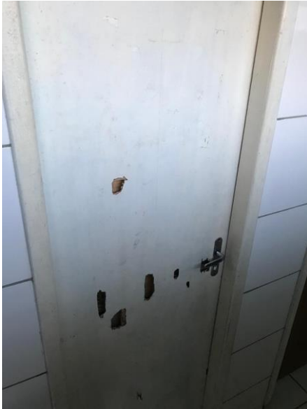
portas danificadas nos banheiros coletivos
