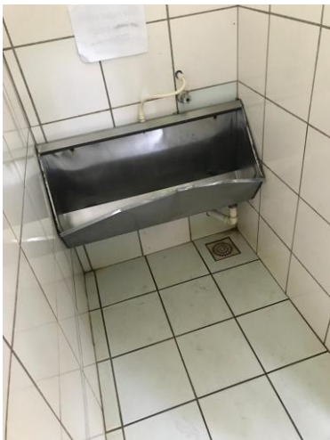
Mictório de aço inox danificado no banheiro coletivo masculino
