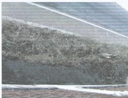
Talude a jusante com alta inclinação.
