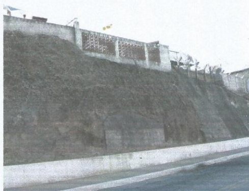
Visão frontal do talude sob o imóvel necessitando de impermeabilização.
