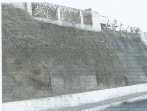
Talude sujeito a infiltração de águas pluviais, podendo ocorrer movimentação.
