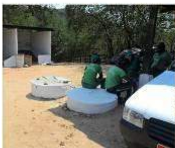
Tanques de chorume
